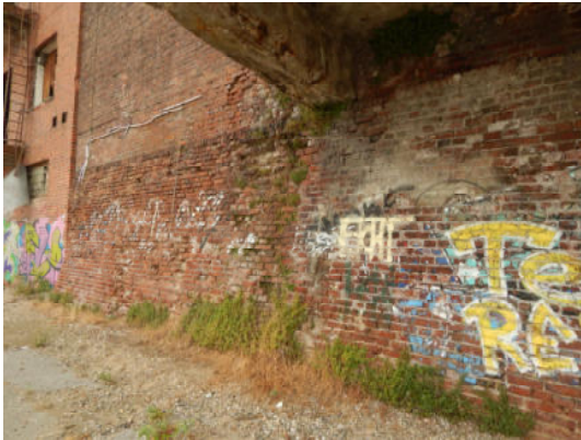
Abb. 7 Beispiel monoton ausgeprägter Mauervegetation.
